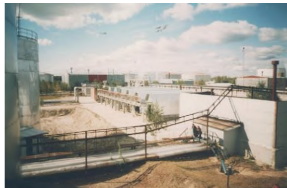
Блочные сооружения биологической очистки сточных вод от метанола Сургутского ЗСК
