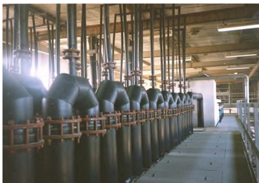
Установка микробной очистки аминных сточных вод на заводе Тенгизского ГКМ
